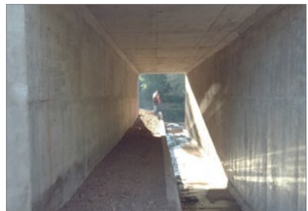
Imagen 18. Pasafaunas subviales. Arriba: estructura exclusiva para la fauna. Abajo: estructura mixta, con función hidráulica y ecológica. Fotos: DPV de Misiones.
