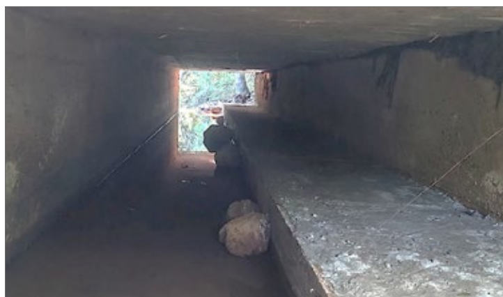
IMAGEN 24: Incorporación de una plataforma seca para el desplazamiento de la fauna silvestre a través de una alcantarilla existente. Proyecto Monitoreo de Alcantarillas en las RN N° 12, RN N° 101 y accesos del Parque Nacional Iguazú, provincia de Misiones. IBS-CONICET-UNaM/FVS/APN/CelBA. Foto: Diego Varela.
