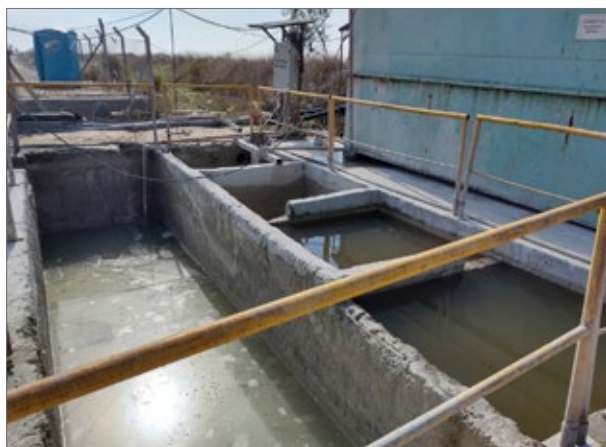
Imagen 8. Piletas de decantación.
