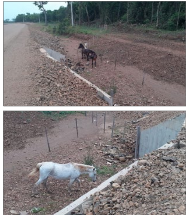
Imagen 23. Pasafauna subvial construido fuera de un área natural protegida sin considerar debidamente la presencia de caballos en la zona, que comenzaron a utilizar la estructura. Aún no se cuenta con evidencias sobre las implicancias de esta situación, por lo que será necesario realizar un monitoreo para evaluar el funcionamiento de esta medida. Fotos: DPV de Misiones.
