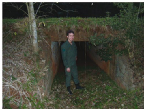
Fotografía 13. Pasafauna subvial de pequeñas dimensiones. Ruta Provincial N° 19, tramo Parque Provincial Uruguai. Provincia de Misiones. (Foto DPV, Misiones).
