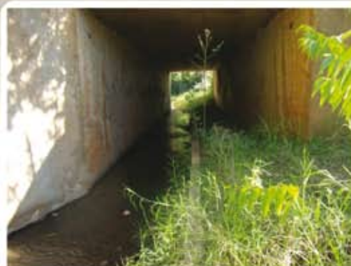
Fotografía 10. Pasafauna Subvial de tipo mixto. Ruta Nacional N° 101, tramo RP N° 19 – Piñalito. Provincia de Misiones. (Foto DPV, Misiones).
