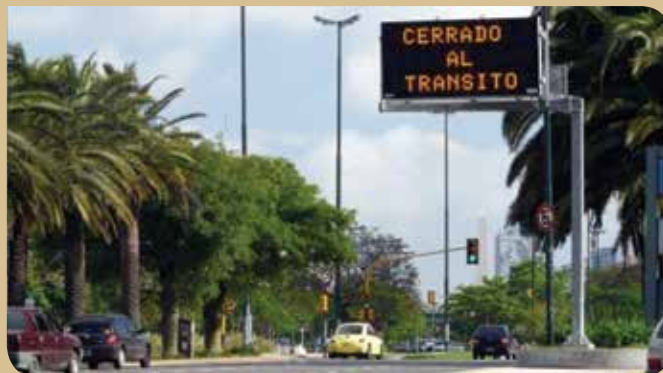
Señales de Mensaje Variable similares a los que serán instalados en la Av. General Paz.
