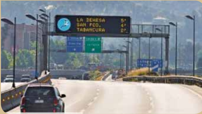
Señal Mensaje Variable Aesys similar a los que serán colocados en los troncales de la Av. General Paz y Acceso Norte. Fuente: Aesys.
